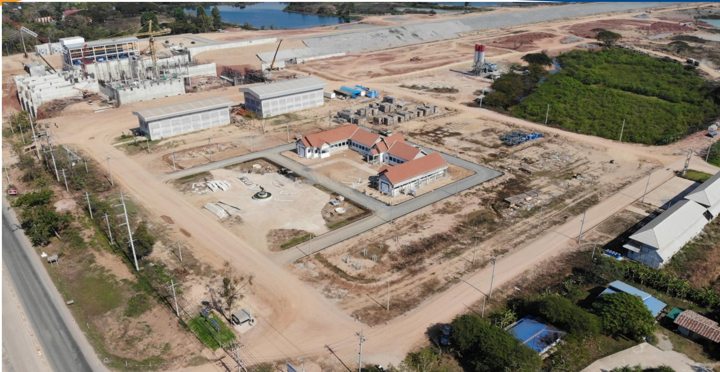
อาคาร Bulkhead Gate พื้นที่จัดเก็บเกียรติ์ และลานภายนอกอาคารสถานที่จัดเก็บเครื่องสูบน้ำและอุปกรณ์
