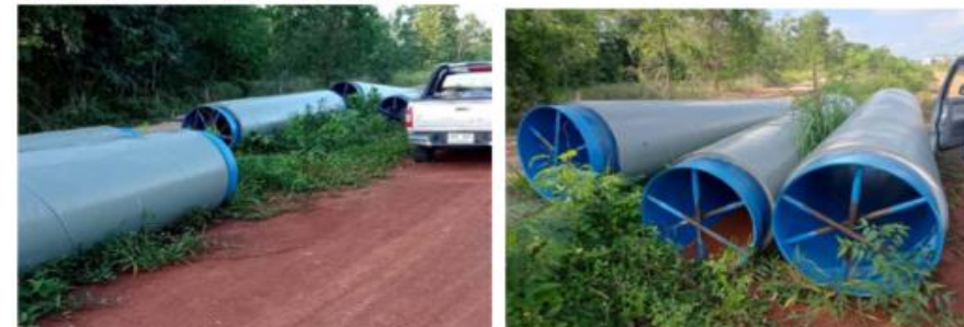
5.3.1.6 รูปที่ 25เมื่อเช็คระดับได้หมดแล้ว จึงเอาท่อตอนที่ 3 ลงติดตั้ง ประกอบ เชื่อม และ ดันไปจนสุดแล้วเอาดินออกแล้ว ทำตามข้อ5.3.1.1 เมื่อเสร็จก็ติดตั้งท่อ4,5,6 ถึงท่อสุดท้าย ทำแบบเดียวกับกับท่อที่1 และ2 จนถึงเป้าหมาย จบขั้นตอนวิธีการงานดินท่อลอดถนน
